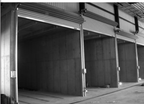
Thöni AirPipe® Belüftungssystem in Rottemodul – Wr. Neustadt
