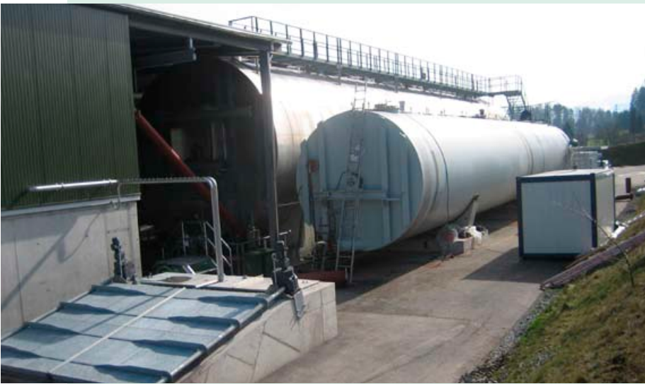
Vergärungsanlage Oetwil am See ZH Centrale de méthanisation
